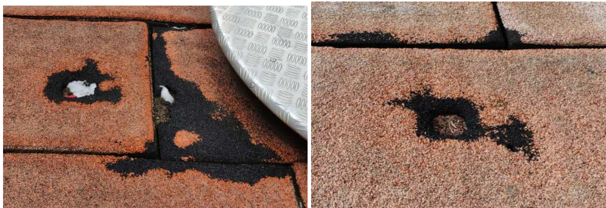
Liczne ubytki w powierzchni
