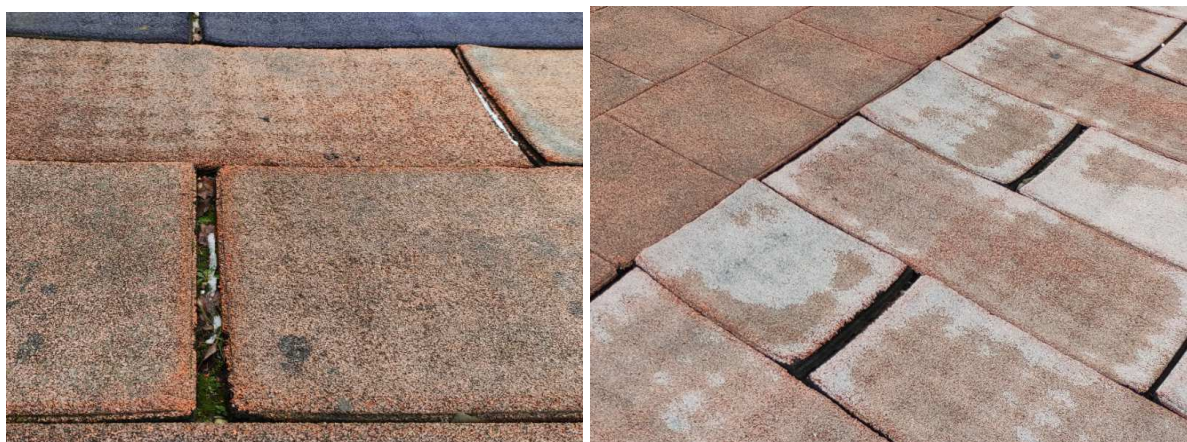
Szczeliny pomiędzy prostokątnymi elementami nawierzchni
